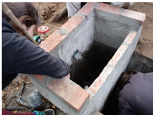
Figura 3: Cámara de carga.
