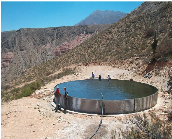
Figura 27: Instalación tanque australiano
