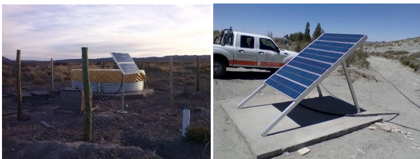
Figura 3: Instalación de bombeo y tanque (izquierda). Panel para sistema Grundfos, Cayupán (derecha).
