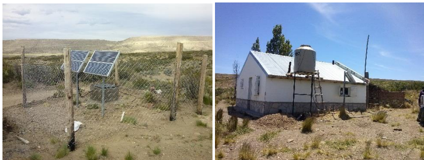
Figura 5: Sistema de bombeo Shurflo (izquierda). Tanque domiciliario instalado y paneles solares (derecha).
